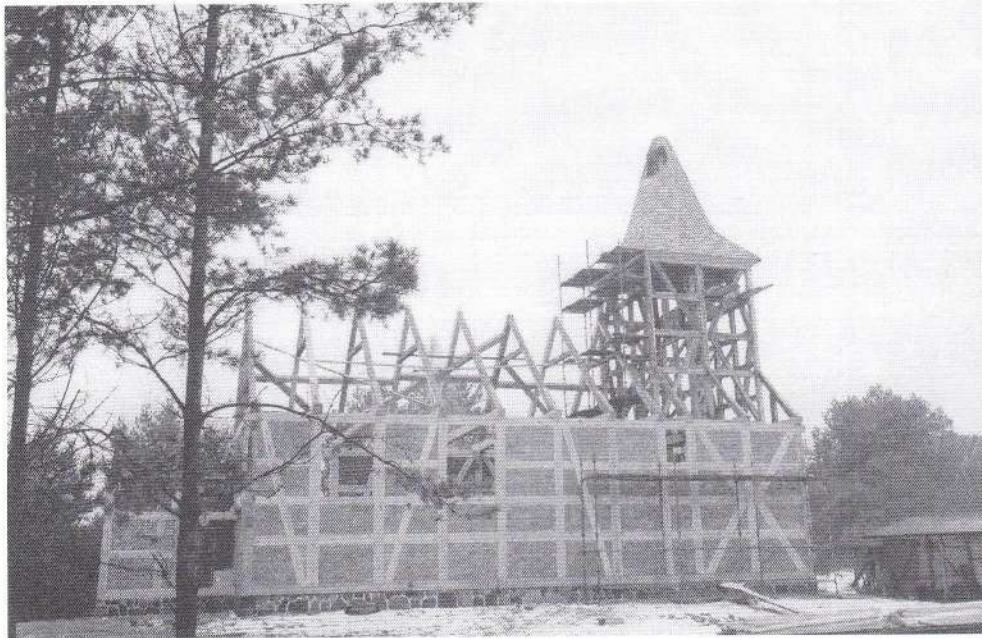
14. Wdzydze Kiszewskie, odbudowa kościoła na terenie Muzeum, stan prac po wykonaniu ceglanego muru wypełniającego i przykryciu gontami hełmu dzwonnicy, widok północno-wschodni; fot. M. Hawryszków, listopad 2009 r.
