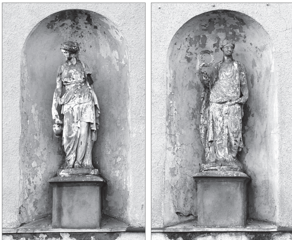
il. 16. Antykizujące postaci kobiet ustawione na postumentach w niszach II kondygnacji, fot. H. Kreft-Gierdalska 2020. W tle widoczne odspajające się warstwy farby, w tym o barwie zieleni brunszwickiej.
