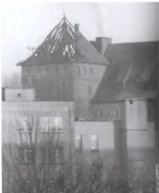
Zniszczona po arem poła dachowa Baszty Prochowej zamku - luty 1994 r. - fot. archiwum muzeum.
