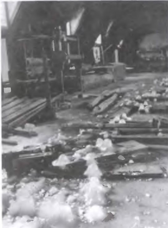
Magazyn zbiorów muzealnych, stan sprzed remontu dachu Domu Zakonnego - fot. archiwum muzeum.
